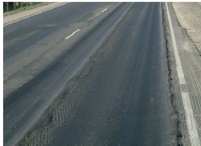
Рис. 1. Пластичні деформації на асфальтобетонному покритті
