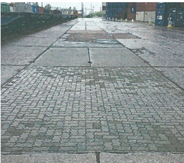
Рис. 2. Стан дорожнього покриття із плит через 5 років на контейнерному терміналі «Схід», і приклад ремонту з застосуванням цементобетонного каменю «Г-подібна хвиля»
