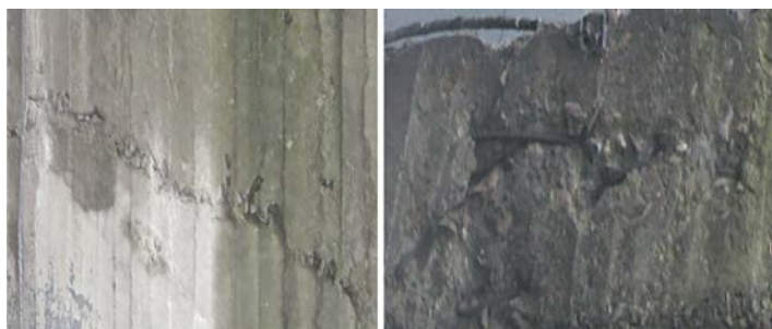
Рис. 6. Оголення арматури та процеси корозії в конструкціях стін підземної частини будівлі
