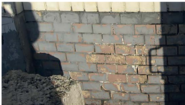
Рис. 5. Локальні тріщини конструкції стін наземної частини будівлі
