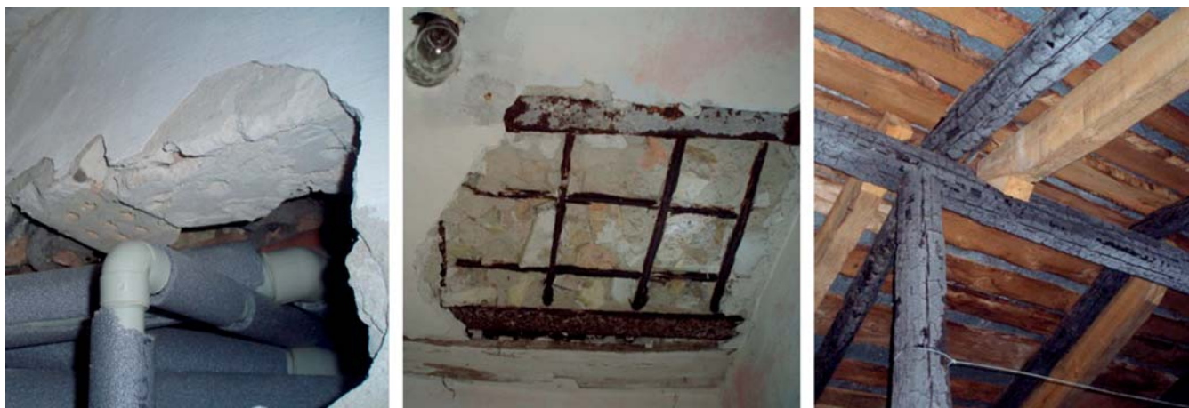
Рис. 3. Стан підвалу, міжповерхового перекриття і горища конструкцій 7-го корпусу нейрохірургічного відділення
