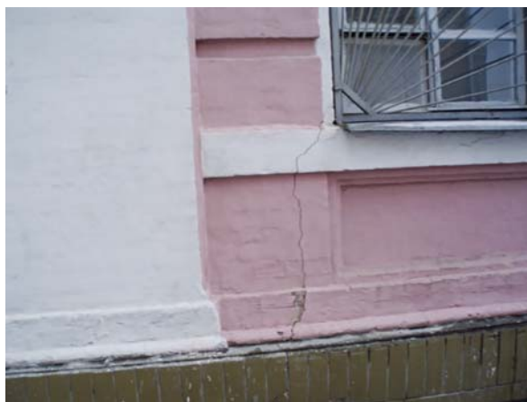
Рис. 3. Наскрізьні тріщини і відлущення облицювальної плитки на громадських будинках в м. Київ
