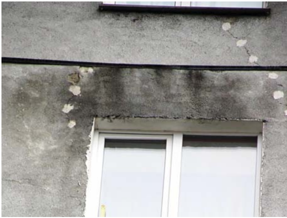
Рис. 5. Тріщини облицювальної кладки житлового багатоповерхового будинку в результаті відсутності вертикальних деформаційних швів в м. Бориспіль
