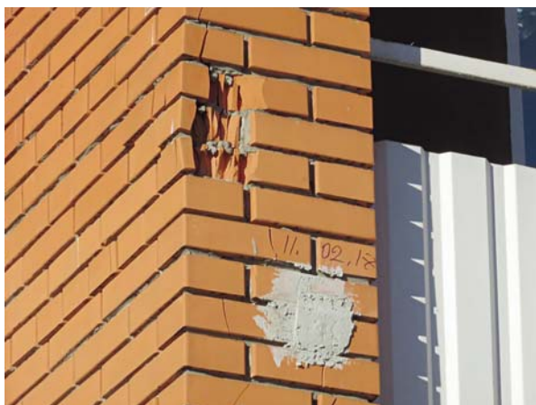
Рис. 1. Відлущення і відставання облицювального цегляного шару в багатоповерховому житловому будинку в м. Чернігів
