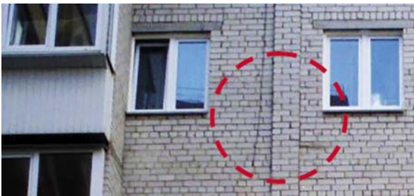
Рис. 6. Тріщини облицювальної кладки житлового багатоповерхового будинку в результаті відсутності вертикальних деформаційних швів в м. Бориспіль
