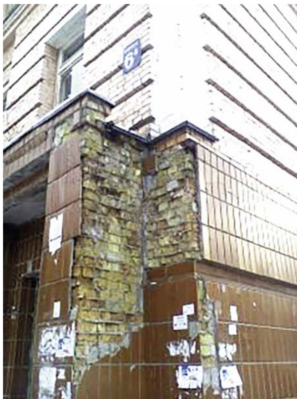
Рис. 4. Наскрізьні тріщини і відлущення облицювальної плитки на громадських будинках в м. Київ
